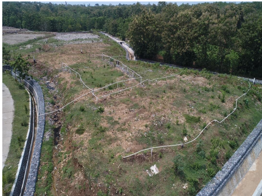
Gambar 4.11 Situasi Instalasi Pipa Gas Di Area TPA (Sumber : Foto Udara dengan menggunakan Drone/Dokumentasi Pribadi)
