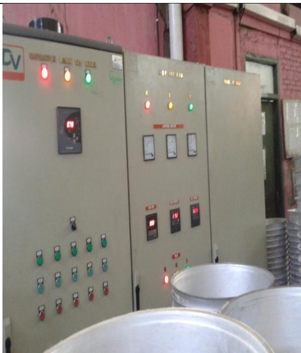
Kondisi Panel Utama di Ruang Produksi
