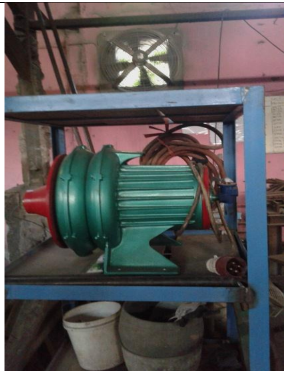
Kondisi Blower Cadangan
