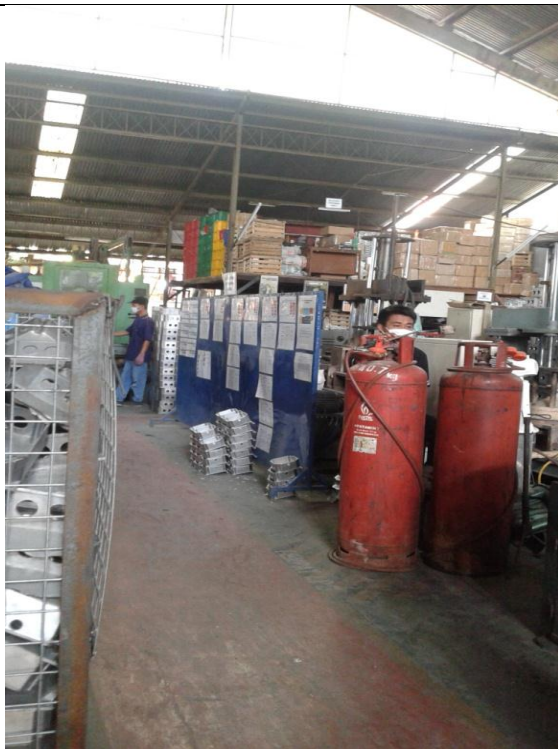
Kondisi LPG di ruang Produksi
