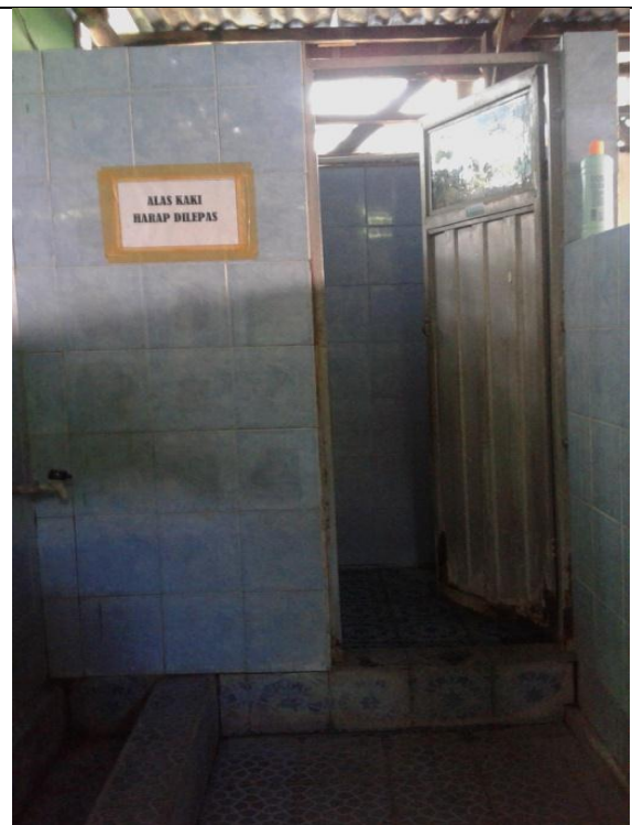
Kondisi Kamar mandi
