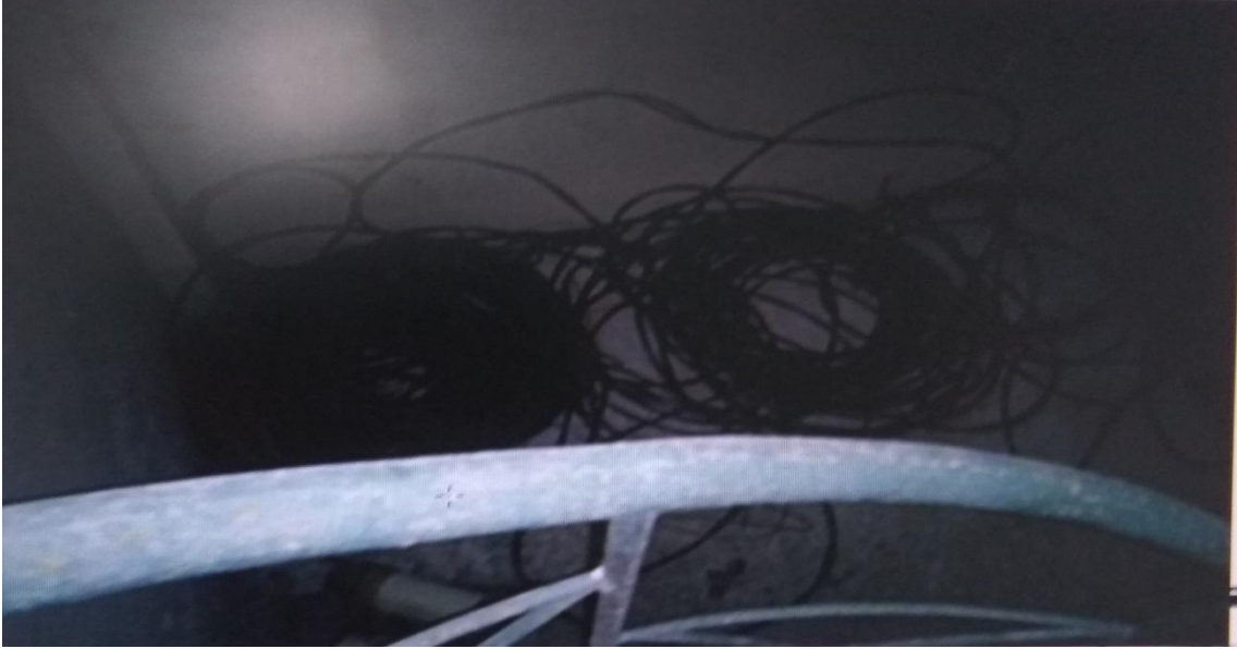
Lampiran 3. Kabel Penyalur Tegangan Listrik PLTMH
