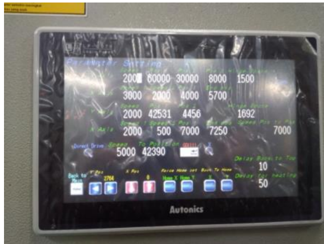
Gambar 4-3 PLC yang sedang mengatur jarak dan frekuensi
