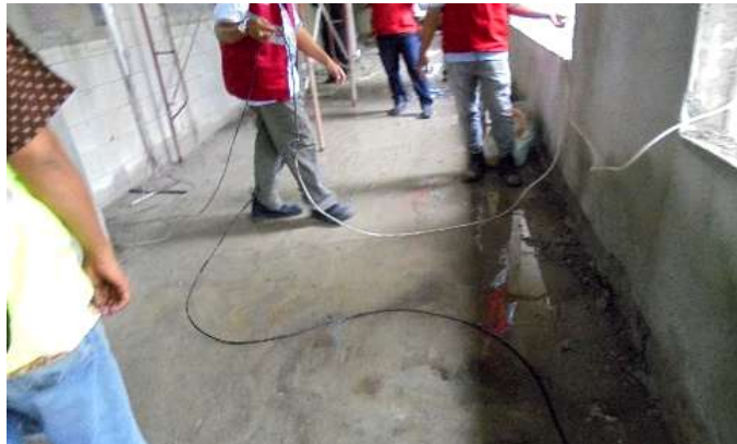
Gambar 5.27 Kabel Listrik Tergenang Air Sumber: Dokumen Pribadi, 2018
