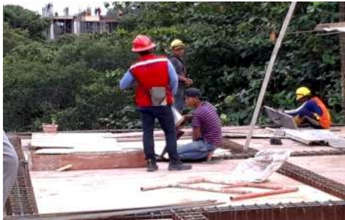
Gambar 5.31 Bekerja tanpa APD Sumber: Dokumen Pribadi, 2018
