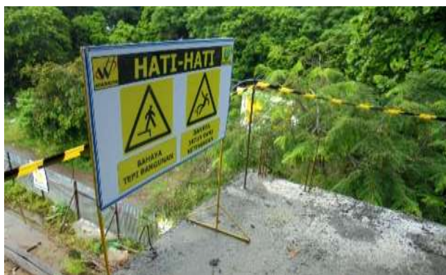
Gambar 5.26 Penempatan Rambu yang Tidak Aman Pada Proyek UNY Yogyakarta 7 in 1
