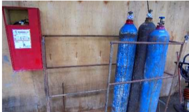
Gambar 5.25 Temuan Tabung Gas Tidak Aman Pada Proyek UNY Yogyakarta 7 in 1
