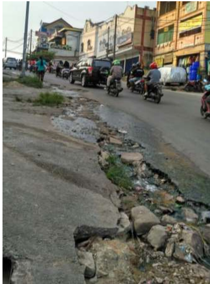
Gambar 5.7 Kondisi Jalan Berlubang Pada Ruas Jalan Batu Ampar Km 2
