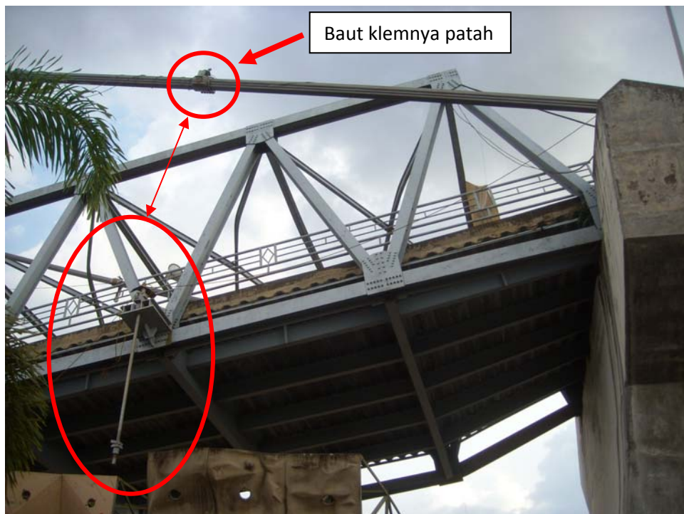
Kabel penggantung vertikal yang terlepas
