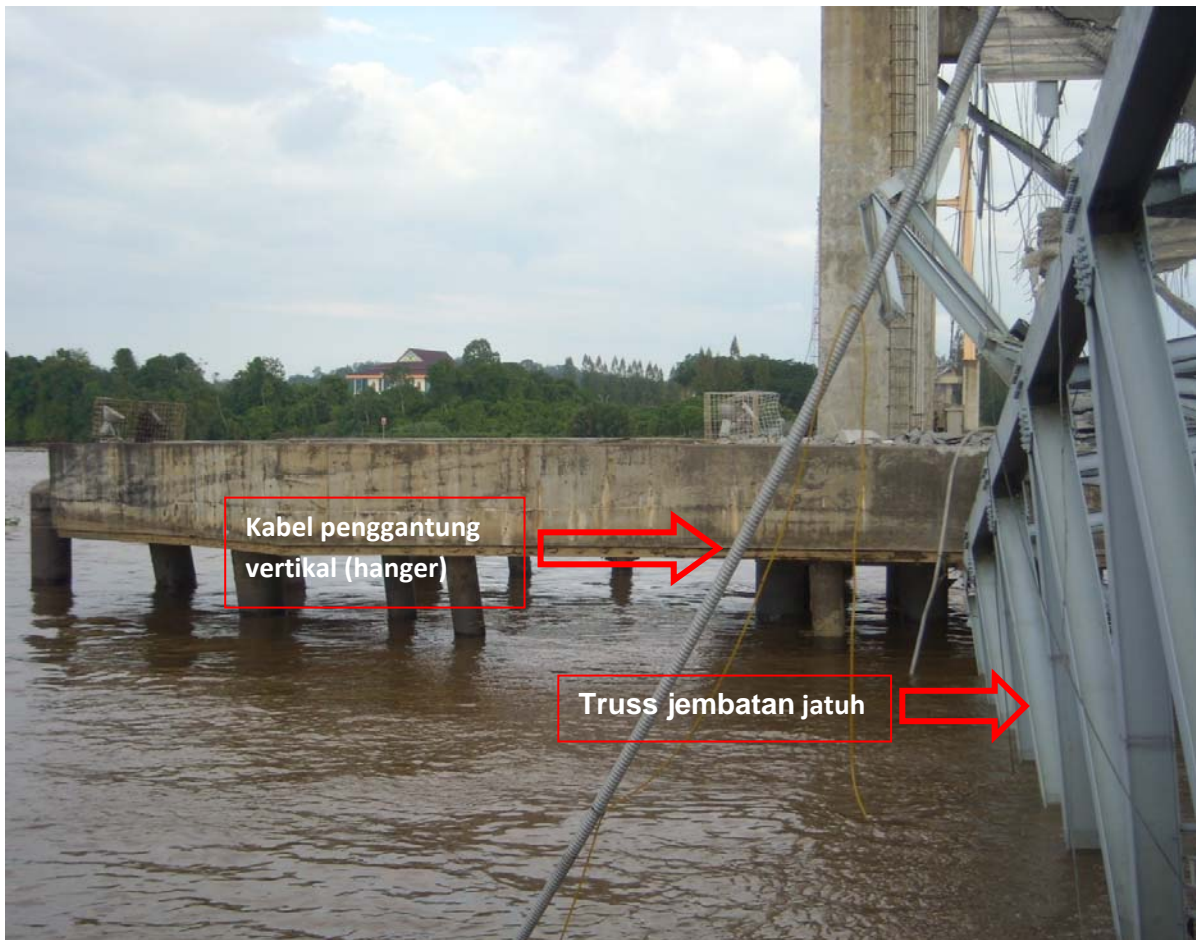
Seluruh truss jembatan jatuh
