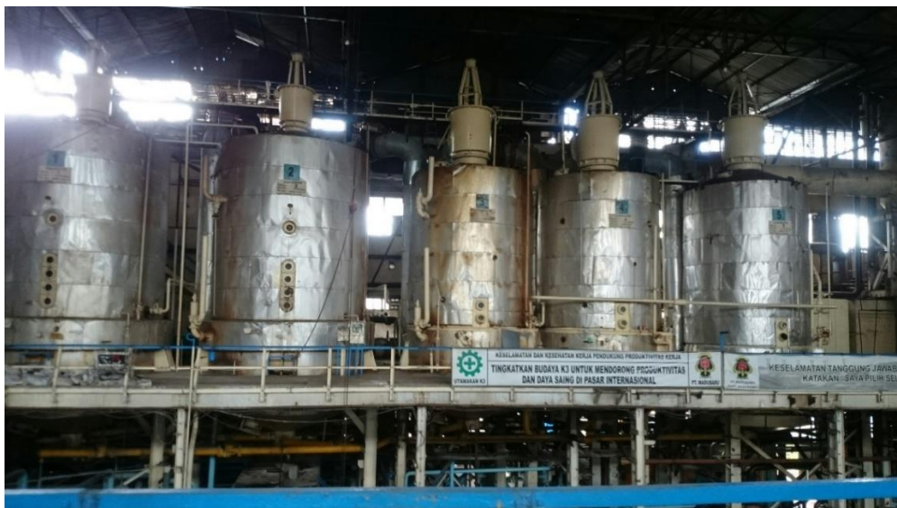
Gambar 4.1 Mesin Evaporator PG. Madukismo
