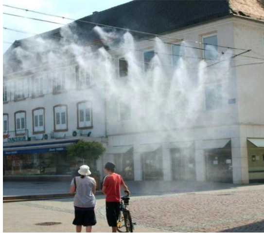
Gambar 2.46 : Penggunaan Water Mist System Pada Lingkungan sumber : admin, 2018
