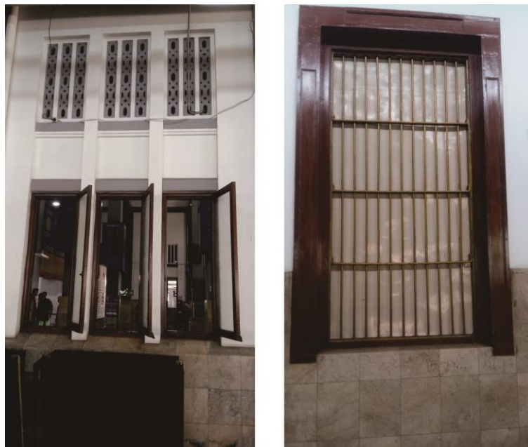
Gambar 2 6 Ventilasi Stasiun Tugu
