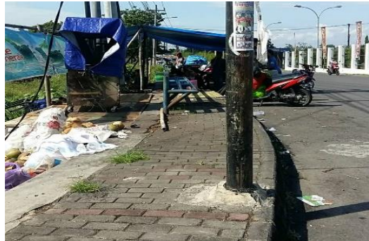
Gambar 3.9 kondisi trotoar didepan stadion
