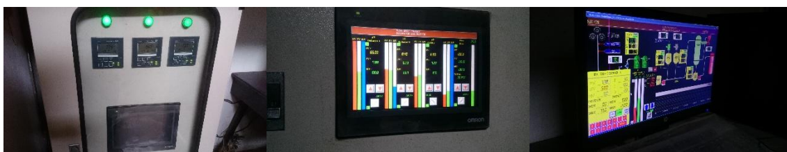
Gambar 4. 9 kotak panel dan ruang pengendalian operator
