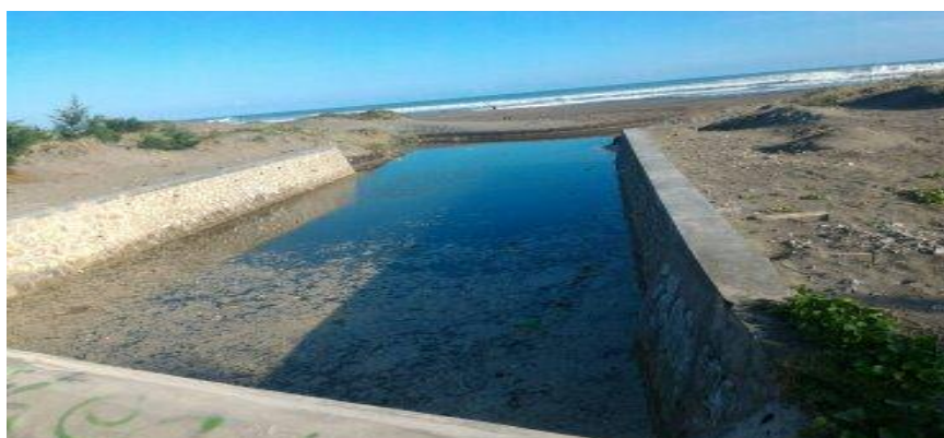
Gambar 4.11 Kondisi saluran air yang tercemar \text{NO}_3 di Pantai Parangtritis
