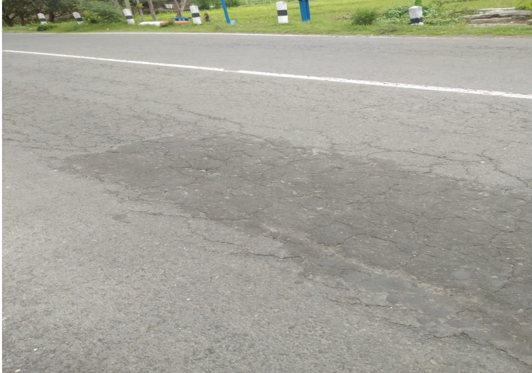
Gambar 1.1 Kondisi Kerusakan pada Ruas Jalan Piyungan-Prambanan
