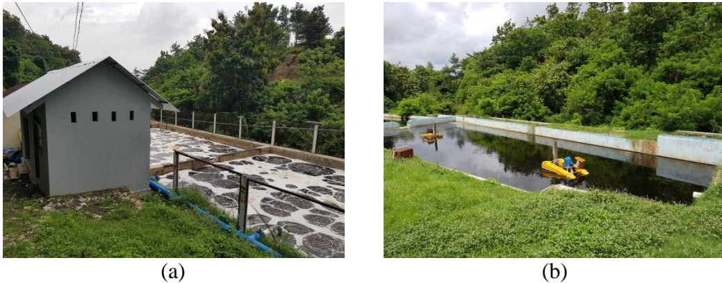
Gambar 4. 2 (a) Kolam Aerasi dan (b) Kolam Disinfeksi IPL Piyungan
