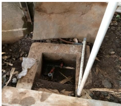
Gambar 4.3 Terminal pipa biogas Desa Pucanganom
