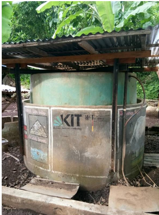
Gambar 4.2 Ruang Digester biogas tipe floating-roof Desa Pucanganom
