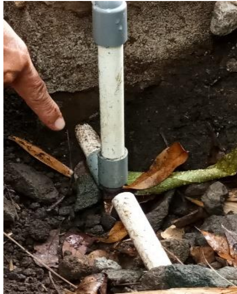
Gambar 4.9 Kesalahan penyambungan pipa
