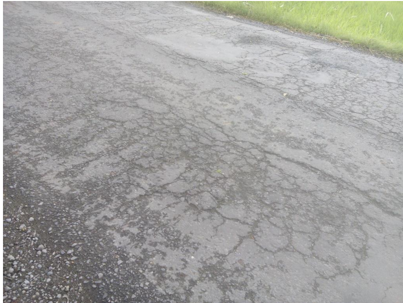
Gambar 1.2 Retak Kulit Buaya pada Sta.0+075
