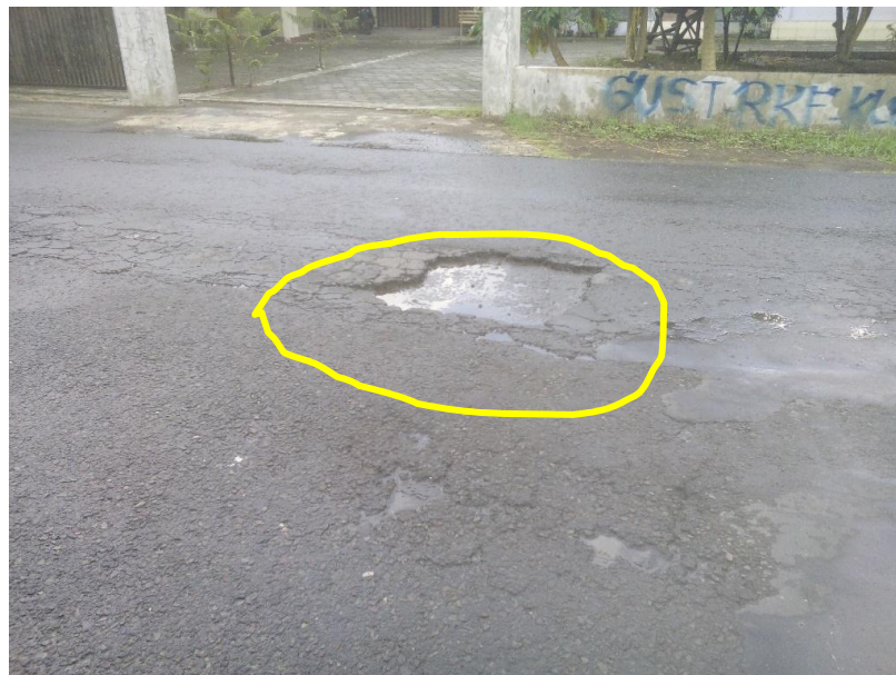
Gambar 1.3 Lubang ( Potholes ) pada Sta.1+300
