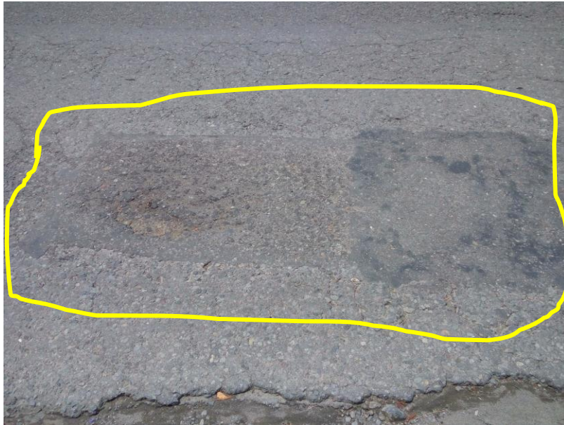
Gambar 1.4 Tambalan pada Sta.0+150
