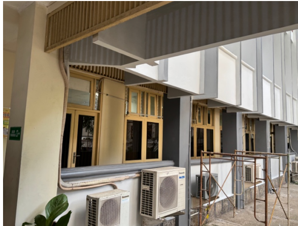
Gambar 5. 28 Kondisi sistem pembuangan air kotor pada selasar gedung rektorat
