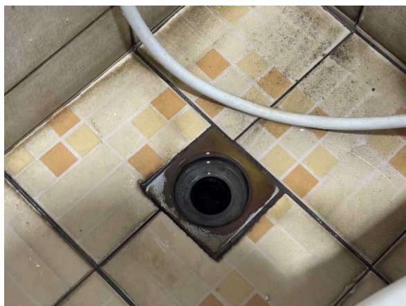
Gambar 5. 30 Kondisi floordrain kamar mandi eksisting gedung rektorat
