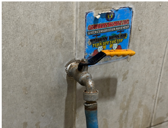
Gambar 5. 31 Kondisi keran air eksisting pada gedung rektorat
