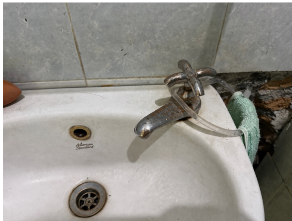
Gambar 5. 29 Kondisi alat penunjang sanitasi
