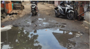
Sistem drainase dan ventilasi tidak berfungsi optimal, menyebabkan turunnya kualitas ruang akibat cat mengelupas, genangan air kotor, dan bau menyengat di pelataran.
