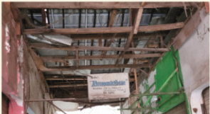
Bangunan mengalami kerusakan tinggi (kritis 70%), ditandai dengan atap yang lapuk, retak pada struktur kolom beton, dan keroposnya pelat lantai akibat kelembapan ekstrem.
