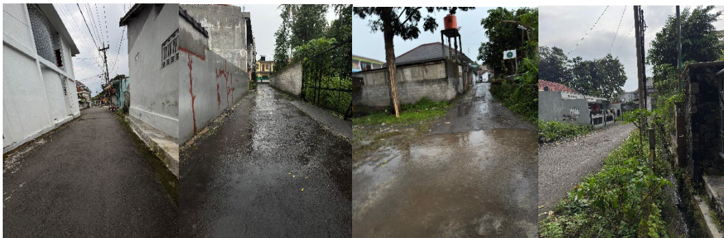
Gambar 1.1 Saluran Drainase Yang Bermasalah
