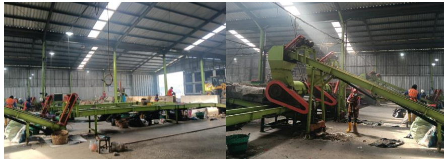
Gambar 4.10 Mesin Konveyor dan Mesin Crusher
