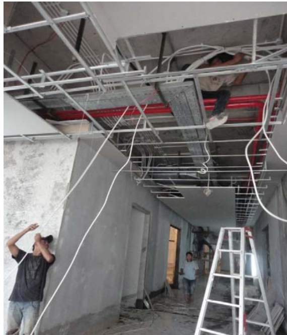
Gambar 5. 1 Pemasangan instalasi listrik tanpa alat pengaman
