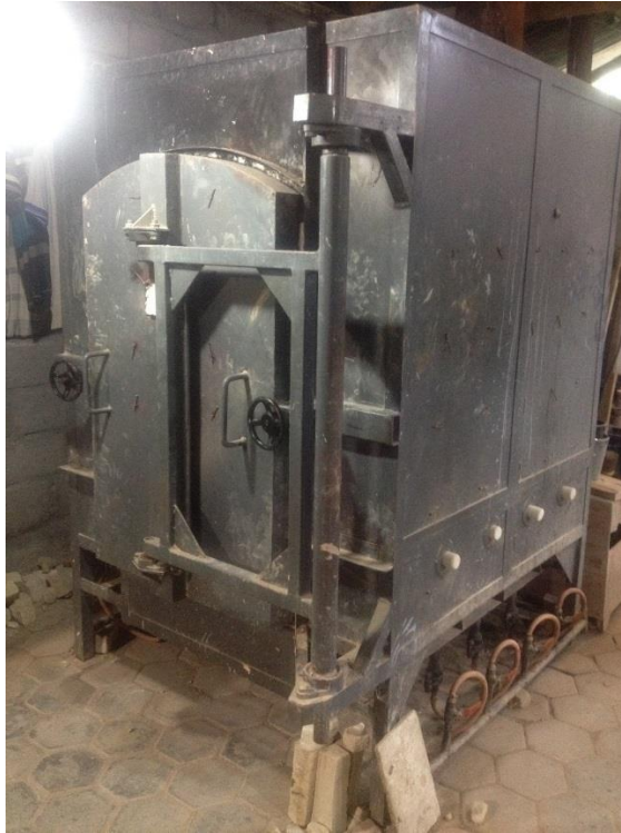
Gambar L-1.7 Furnanace (alat pembakaran)
