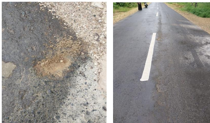
Gambar 5. 4 Kondisi Perkerasan Akibat Drainase Kurang Baik
