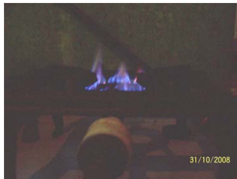
Gambar 4.18 Kompor yang menggunakan biogas dari digester
