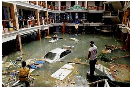
Gambar 1.4 Bangunan rusak akibat Tsunami (Sumber: Google search, 2008)
