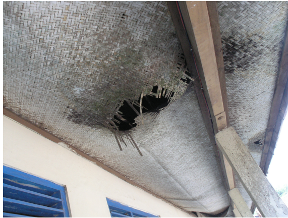
Gambar 2.4 Kerusakan langit-langit akibat rembesan air
