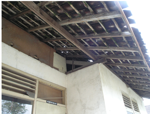
Gambar 2.5 Kerusakan atap pada ruang perpustakaan
