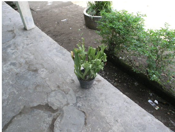
Gambar 2.2 Kerusakan lantai pada selasar ruang kelas
