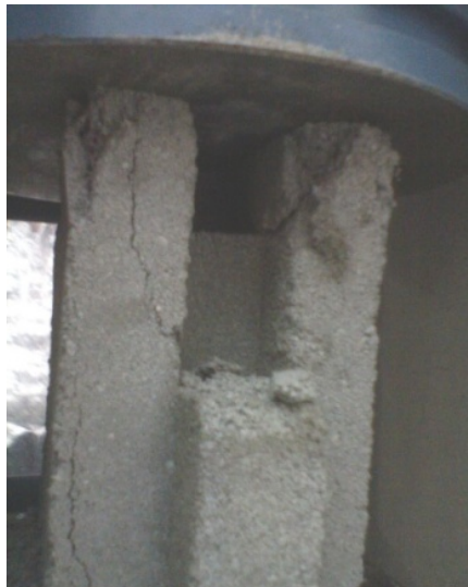
Gambar 5.1 Pola Kerusakan pada Uji Tekan
