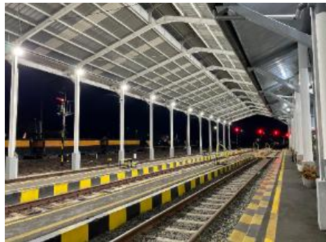
Gambar 5.24 Kondisi Penerangan Area Stasiun 2
