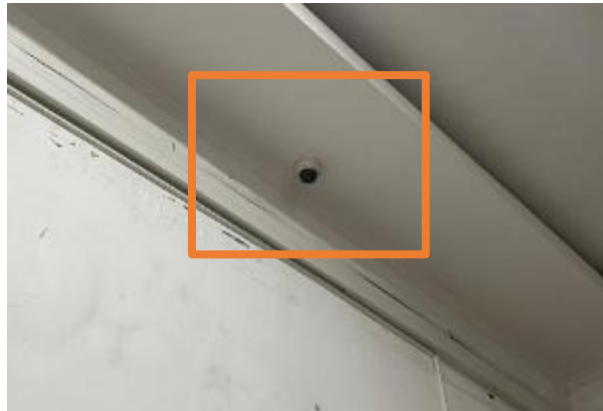
Gambar 5.18 CCTV di Area Tidak Bertiket
