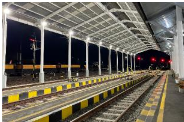
Gambar 5.40 Penerangan Area Stasiun
