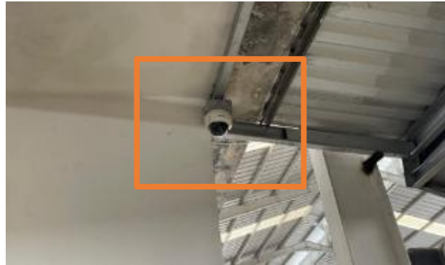
Gambar 5.17 CCTV di Area Bertiket dan Peron
