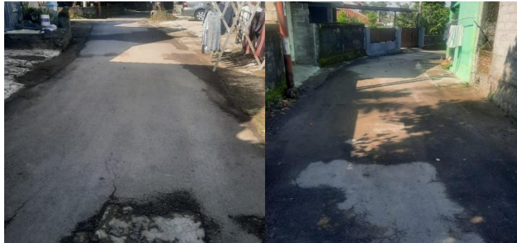
Gambar 1.1 Jalan Yang Tidak Tersedia Saluran
