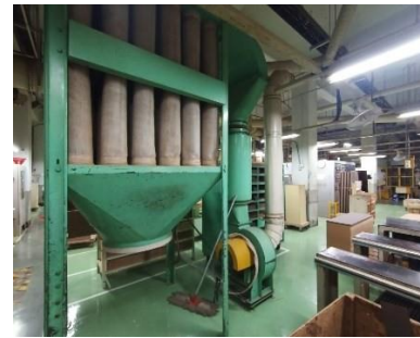
Gambar 4. 16 Dust Collector yang udah tidak berfungsi Sumber: Dokumentasi Pribadi
