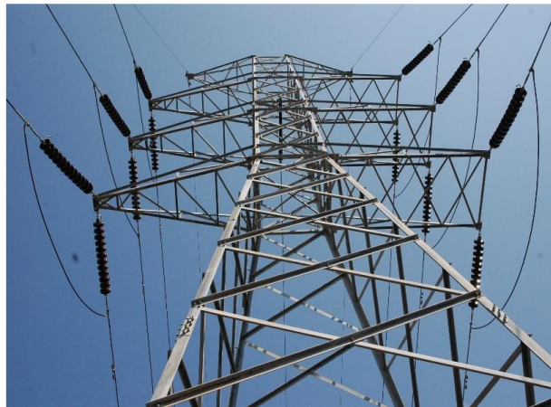
Gambar 2.2 Saluran Udara Tegangan Tinggi
