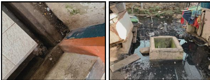
Gambar 1.9 Kondisi Drainase di TPI Tawang Sumber : Dokumen Penulis, 2025
