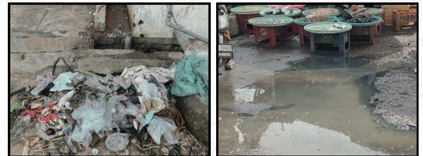
Gambar 1.8 Kondisi Drainase di TPI Tawang Sumber : Dokumen Penulis, 2025
