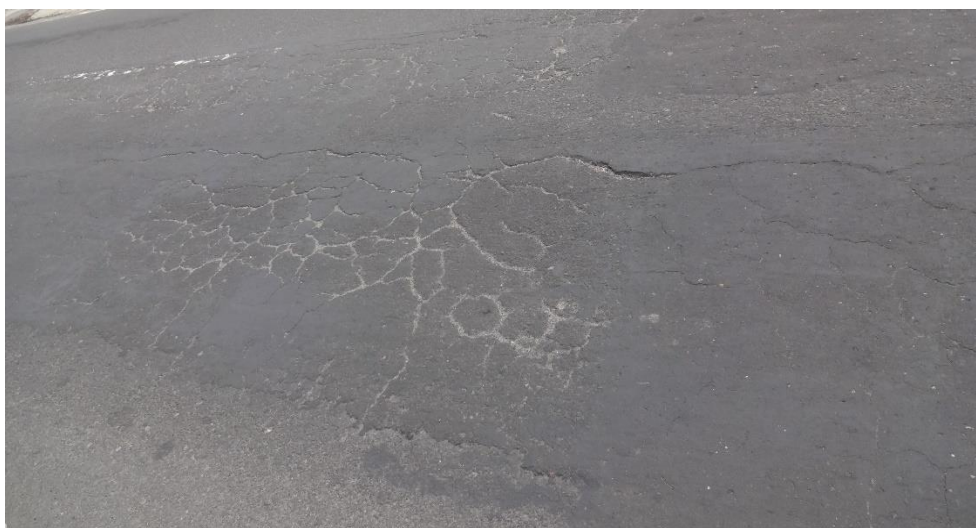
Gambar 5.26 Kondisi Permukaan Segmen 18
