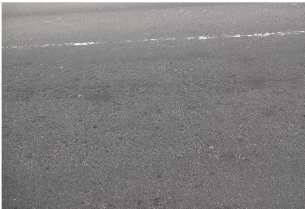
Gambar 5.30 Kondisi Permukaan Segmen 22
