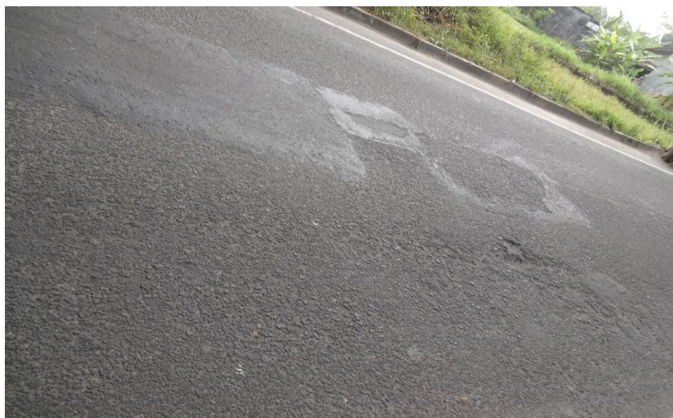
Gambar 5.28 Kondisi Permukaan Segmen 20
