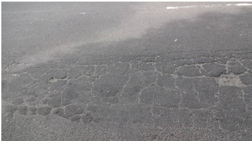
Gambar 5.24 Kondisi Permukaan Segmen 16
