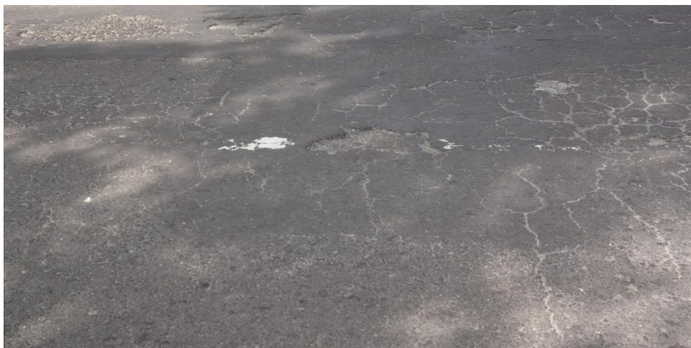
Gambar 5.21 Kondisi Permukaan Segmen 13
