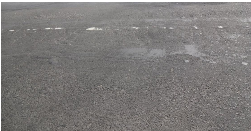
Gambar 5.16 Kondisi Permukaan Segmen 8
