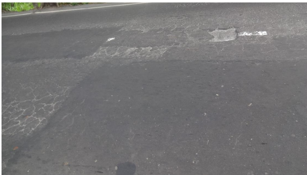
Gambar 5.11 Kondisi Permukaan Segmen 3
