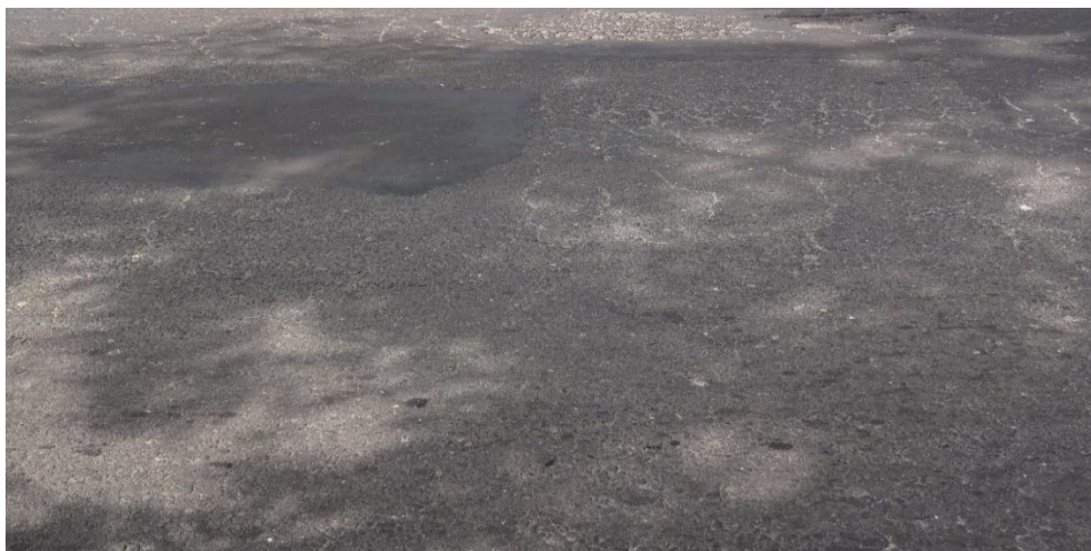
Gambar 5.20 Kondisi Permukaan Segmen 12
