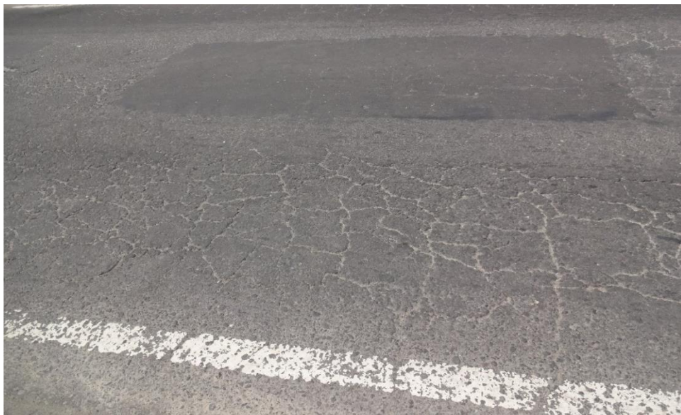
Gambar 5.22 Kondisi Permukaan Segmen 14
