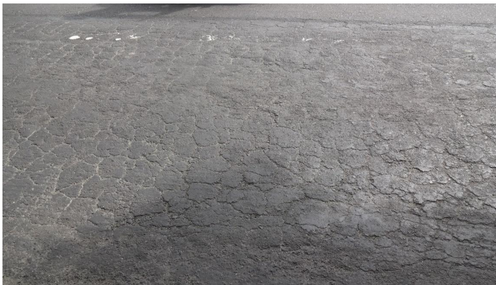
Gambar 5.18 Kondisi Permukaan Segmen 10
