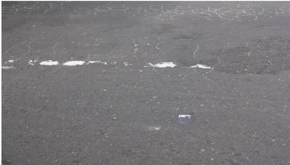
Gambar 5.19 Kondisi Permukaan Segmen 11
