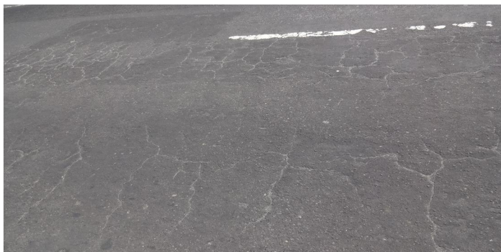
Gambar 5.14 Kondisi Permukaan Segmen 6
