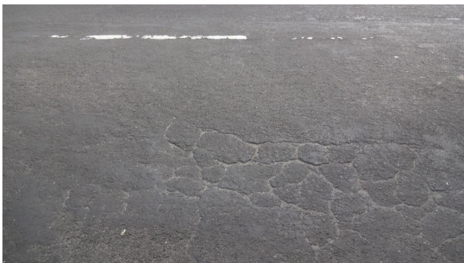
Gambar 5.17 Kondisi Permukaan Segmen 9
