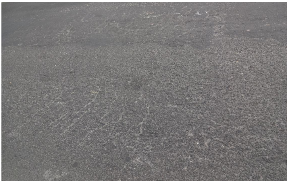
Gambar 5.30 Kondisi Permukaan Segmen 21
