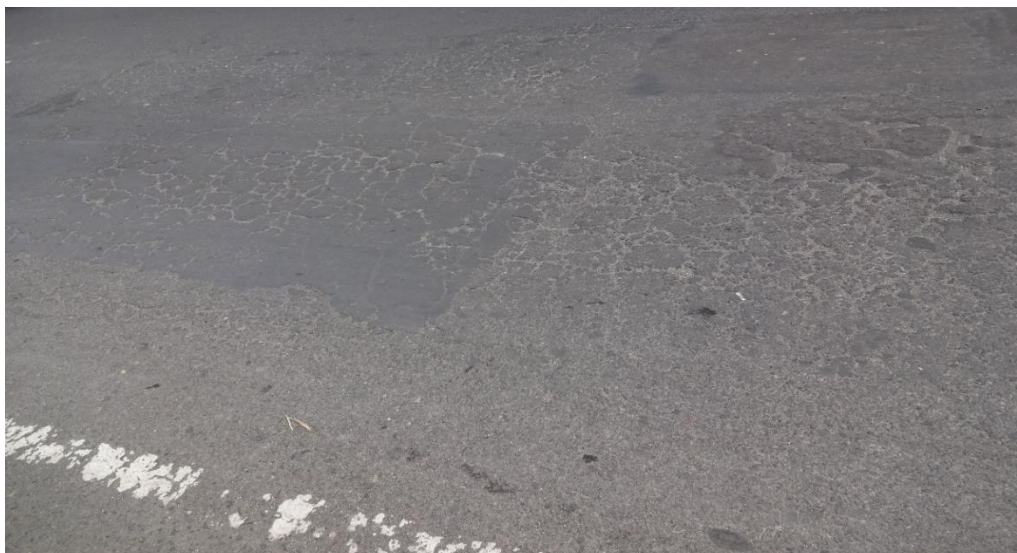
Gambar 5.25 Kondisi Permukaan Segmen 17
