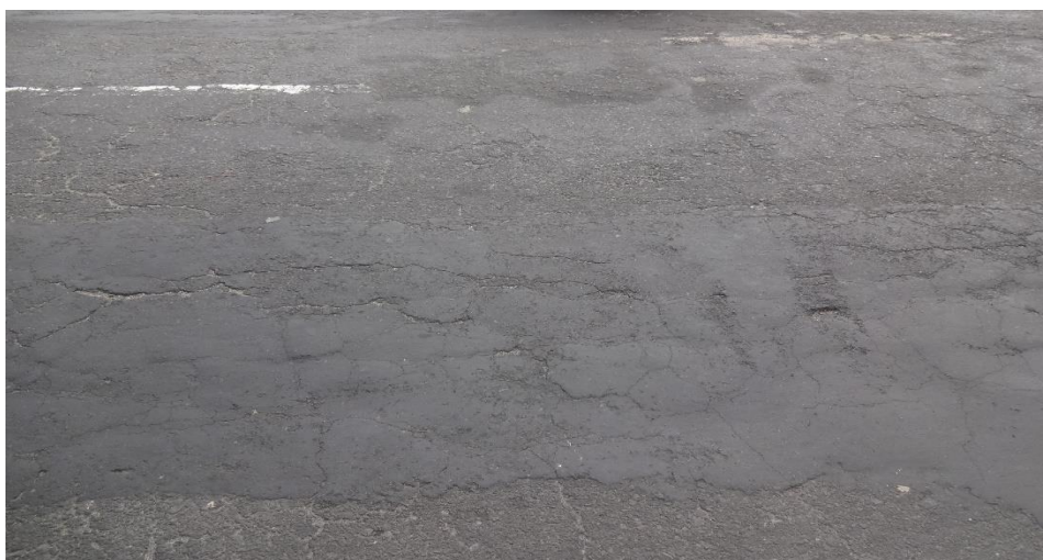
Gambar 5.27 Kondisi Permukaan Segmen 19
