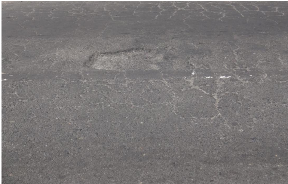
Gambar 5.23 Kondisi Permukaan Segmen 15
