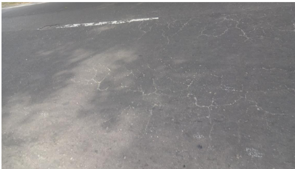
Gambar 5.10 Kondisi Permukaan Segmen 2
