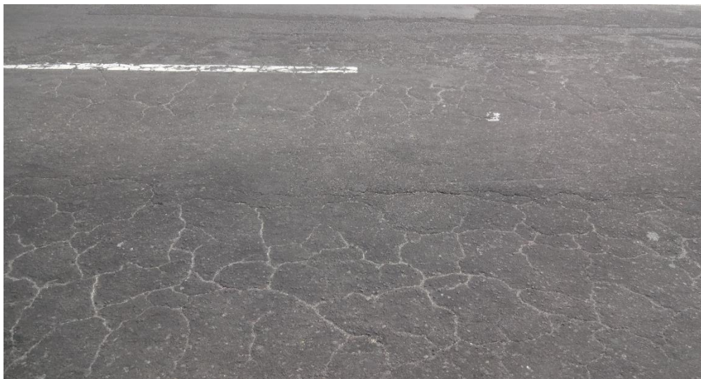
Gambar 5.13 Kondisi Permukaan Segmen 5
