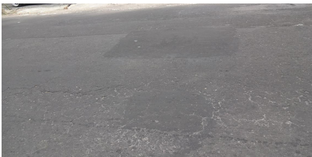
Gambar 5.9 Kondisi Permukaan Segmen 1
