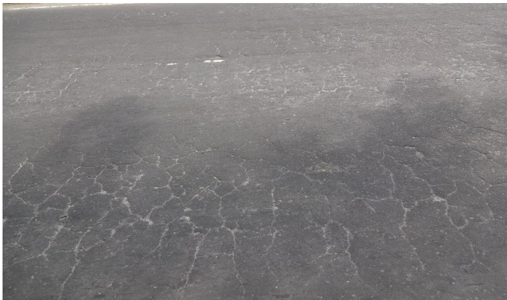
Gambar 5.12 Kondisi Permukaan Segmen 4
