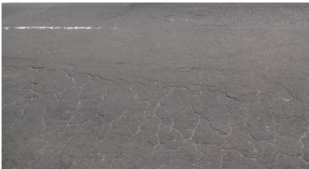
Gambar 5.15 Kondisi Permukaan Segmen 7
