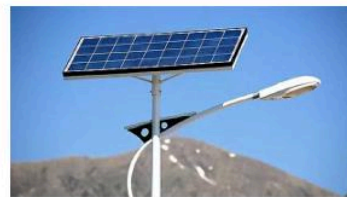
Lampu jalan tenaga surya 60 watt digunakan sebagai upaya memajukan energi alternatif. Lampu PV dipasang setiap 50 meter.
