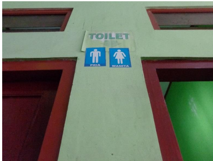
Gambar 4.3 Stiker Pemisah Toilet
