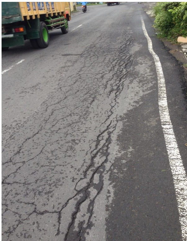
Gambar L-8.4 Kerusakan Jalan Lajur Turi-Pakem Sta. 2+800
