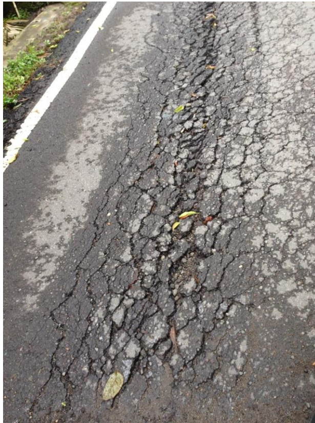
Gambar L-8.2 Kerusakan Jalan Lajur Pakem-Turi Sta. 3+200
