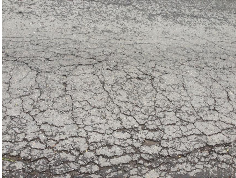
Gambar L-8.1 Kerusakan Jalan Lajur Turi-Pakem Sta. 3+700
