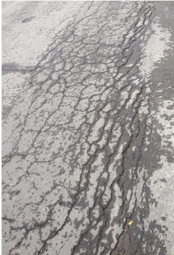
Gambar L-8.3 Kerusakan Jalan Lajur Turi-Pakem Sta. 3+700
