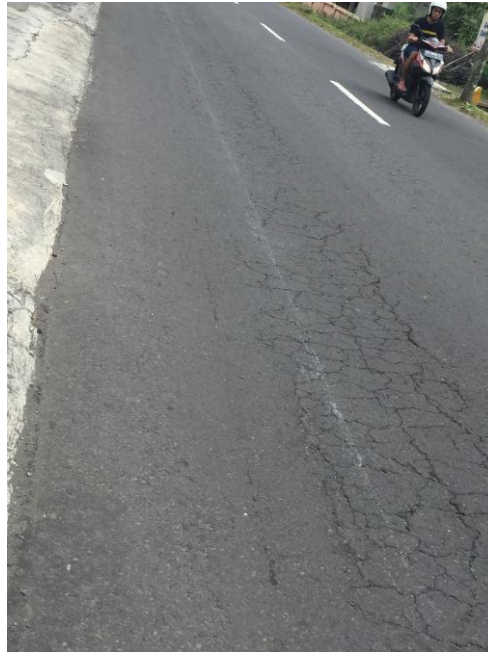
Gambar 5.10 Kondisi Perkerasan pada Segmen 7
