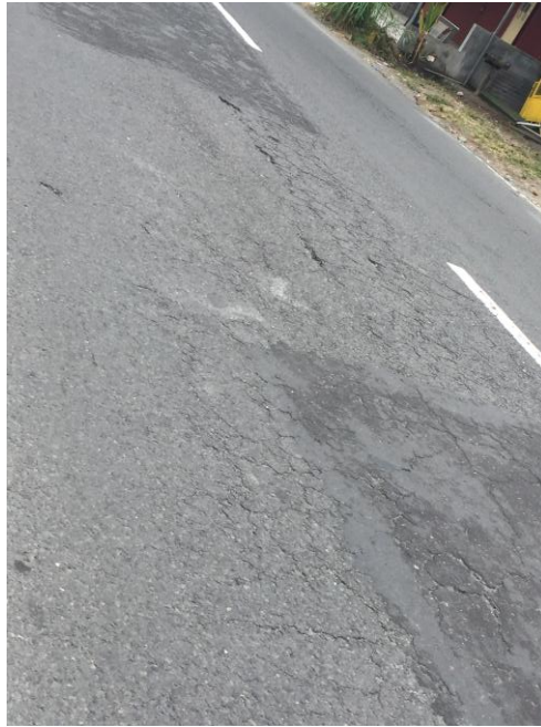
Gambar 5.4 Kondisi Perkerasan pada Segmen 1
