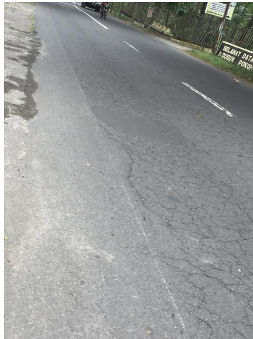
Gambar 5.11 Kondisi Perkerasan pada Segmen 8
