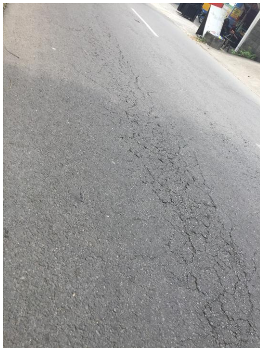
Gambar 5.13 Kondisi Perkerasan pada Segmen 10
