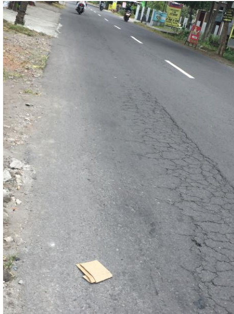
Gambar 5.8 Kondisi Perkerasan pada Segmen 5
