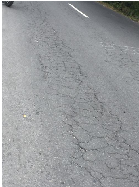
Gambar 5.7 Kondisi Perkerasan pada Segmen 4
