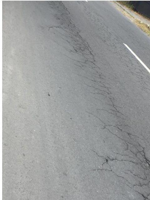
Gambar 5.6 Kondisi Perkerasan pada Segmen 3
