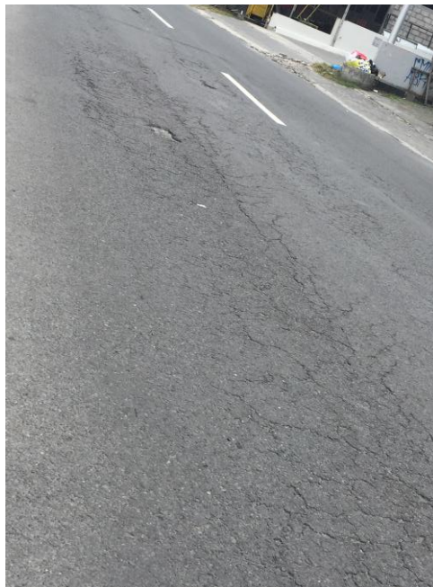
Gambar 5.5 Kondisi Perkerasan pada Segmen 2
