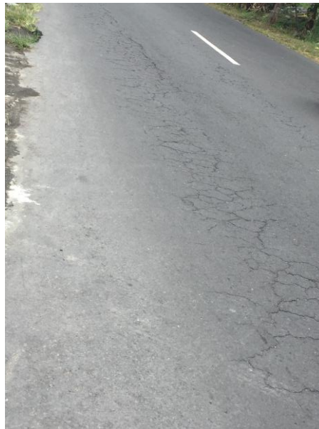
Gambar 5.9 Kondisi Perkerasan pada Segmen 6
