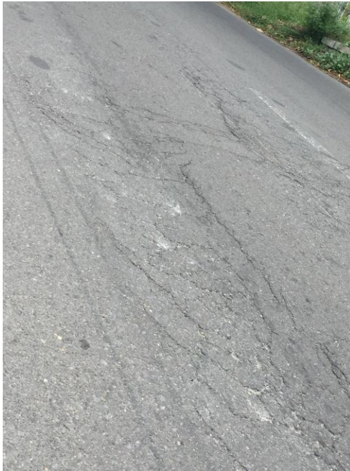
Gambar 5.12 Kondisi Perkerasan pada Segmen 9
