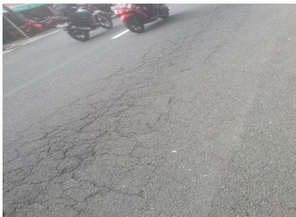
Gambar 1.1 Kerusakan Pada Jalan Raya Tajem
