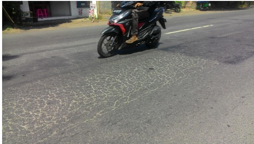
Gambar 1.1 Kerusakan pada Jalan Parangtritis (Retak Kulit Buaya) Sta. 2+700
