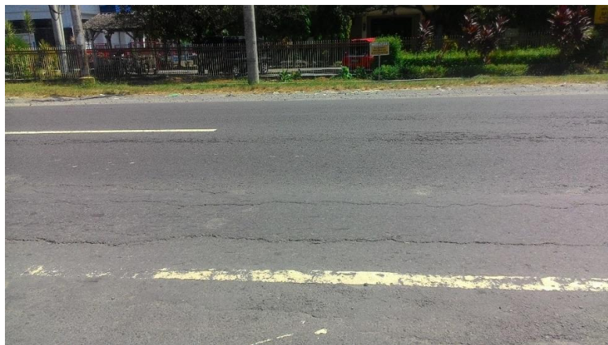
Gambar 1.2 Kerusakan pada Jalan Parangtritis (Bekas Roda) Sta. 2+600
