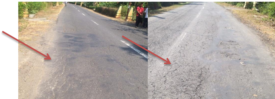
Gambar 1.1 Kerusakan pada Jalan
