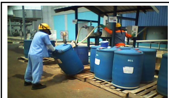
Operator melakukan pengisian bahan kimia untuk injeksi air boiler.
