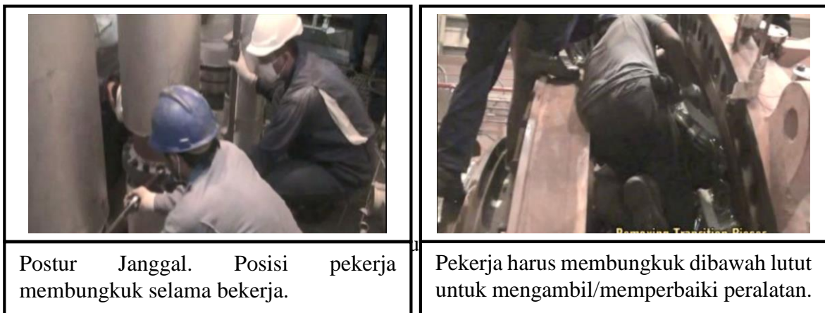
Gambar 4.4. AKTIVITAS perbaikan kebocoran pipa boiler/HKSG posisi membungkuk dan perbaikan gas turbine dengan posisi tulang belakang memutar
