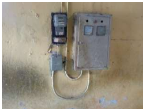
Gambar 4.5 Meteran Listrik Pasar Legi Kotagede
