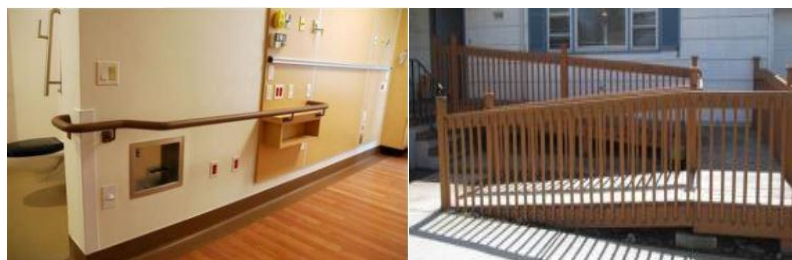
Gambar 2.3 Ramp dan Handrail pada Senior Housing
