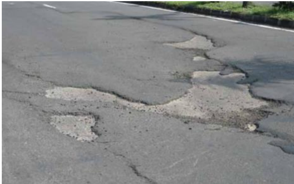
Gambar 3.4 Contoh Kerusakan Tekstur Permukaan ( delamination )
