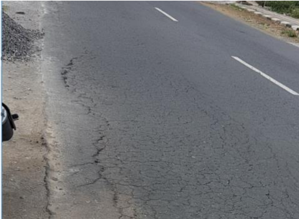
Gambar L-5. 3 Kerusakan Retak Pinggir ( edge cracking )
