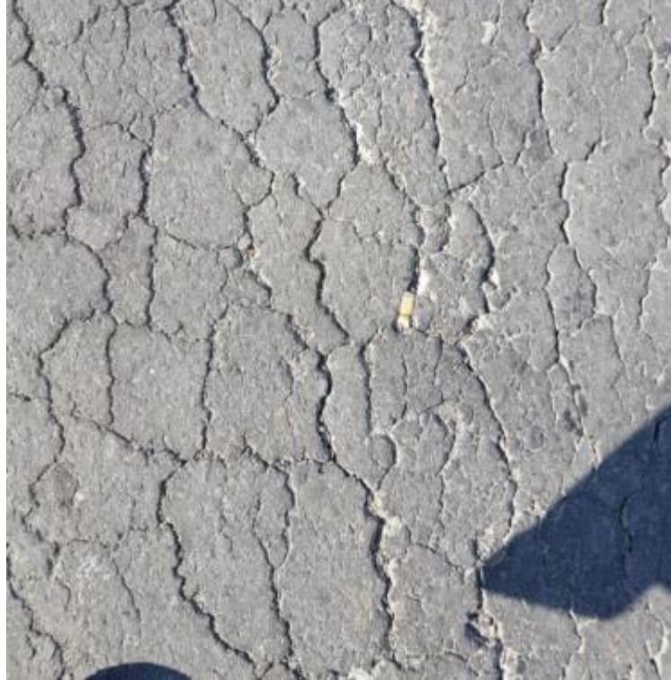
Gambar L-5. 1 Kerusakan Aligator Cracking
