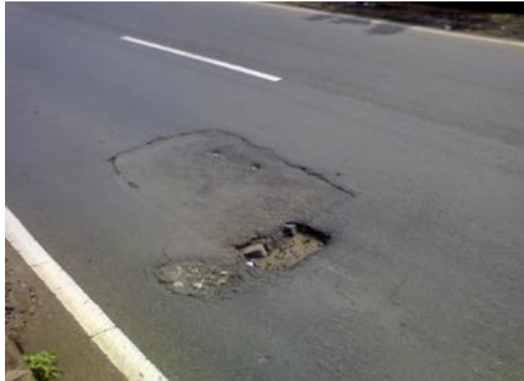
Gambar 3.5 Kerusakan Lubang dan Tambalan
