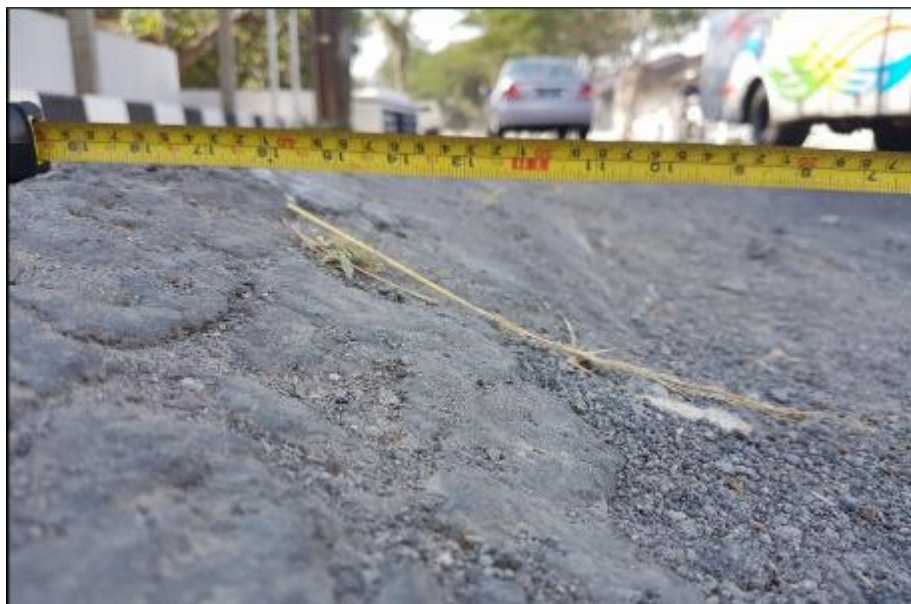
Gambar L-5. 2 Kerusakan Amblas ( depression )
