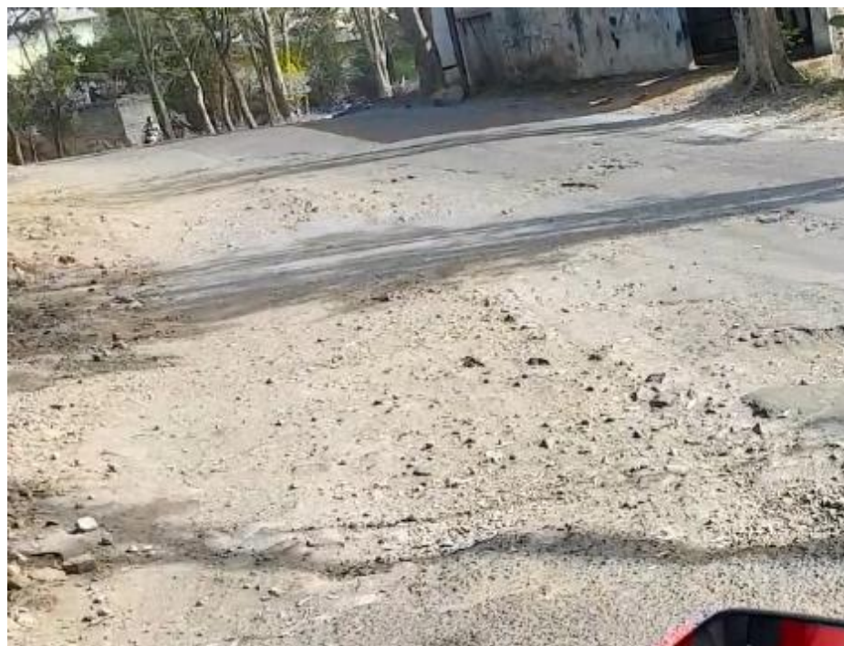
Gambar L-5. 5 Kerusakan butiran lepas ( weathering and ravelling )
