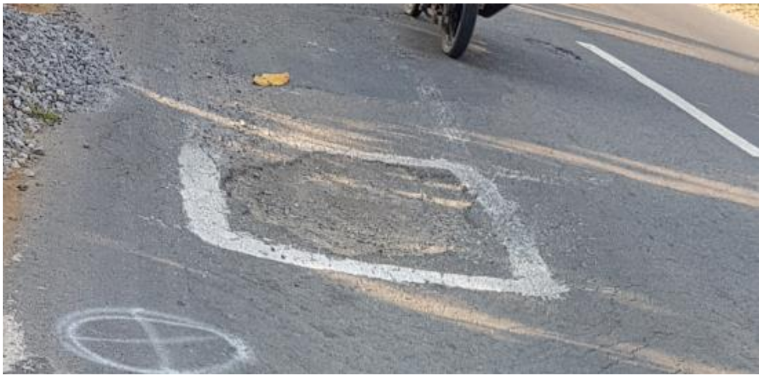
Gambar L-5. 6 Kerusakan Lubang ( potholes )
