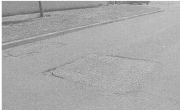
Gambar 3. 6 Contoh Kerusakan Patching
