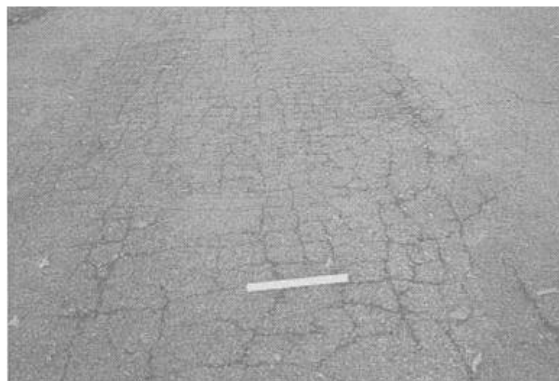
Gambar 3. 1 Gambar Kerusakan Alligator Cracking
