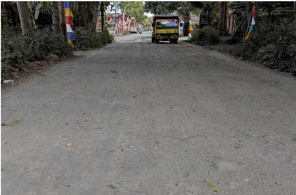
Gambar 1.3 Kerusakan Terparah pada Ruas Jalan Karang Bolong
