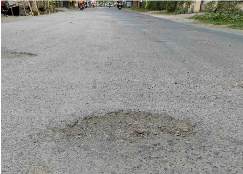
Gambar 1.4 Kerusakan Jalan Jenis Lubang
