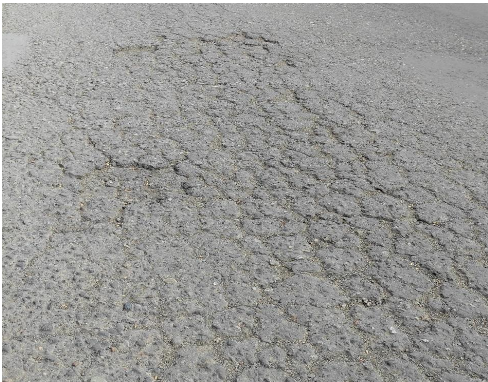
Gambar 1.5 Kerusakan Jalan Jenis Retak Kulit Buaya
