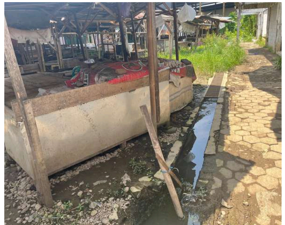
Gambar 1.7 Kondisi Saluran Drainase Pasar Sragi (Sumber: Dokumentasi Penulis)
