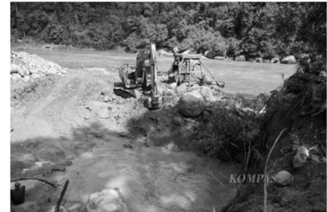
Eskavator mengeruk material di pinggir Sungai Batang Kuantan dalam kawasan Taman Bumi Nasional Silokek, Kabupaten Sijunjung, Sumatera Barat, Kamis (29/11/2019). Aktivitas tambang emas ilegal itu merusak sempadan sungai dan mengancam status kawasan itu sebagai taman bumi nasional.
