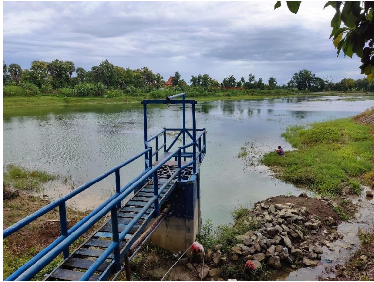
Gambar 4.1 Sumber Air Baku & Bangunan Intake
