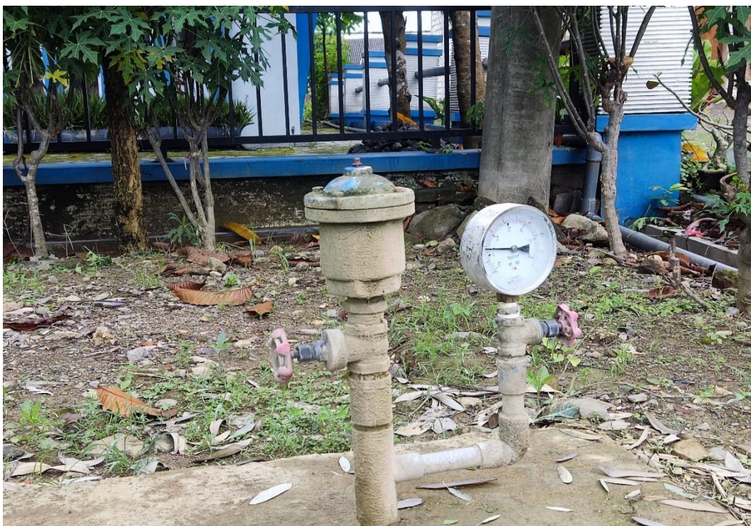
Gambar Meteran Air dari Pompa Intake menuju IKK Sulang PDAM Banyumili
