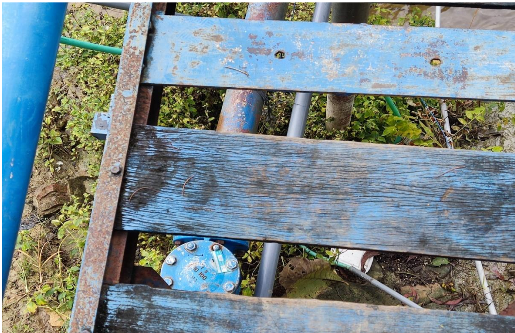
Gambar Pipa Transmisi
