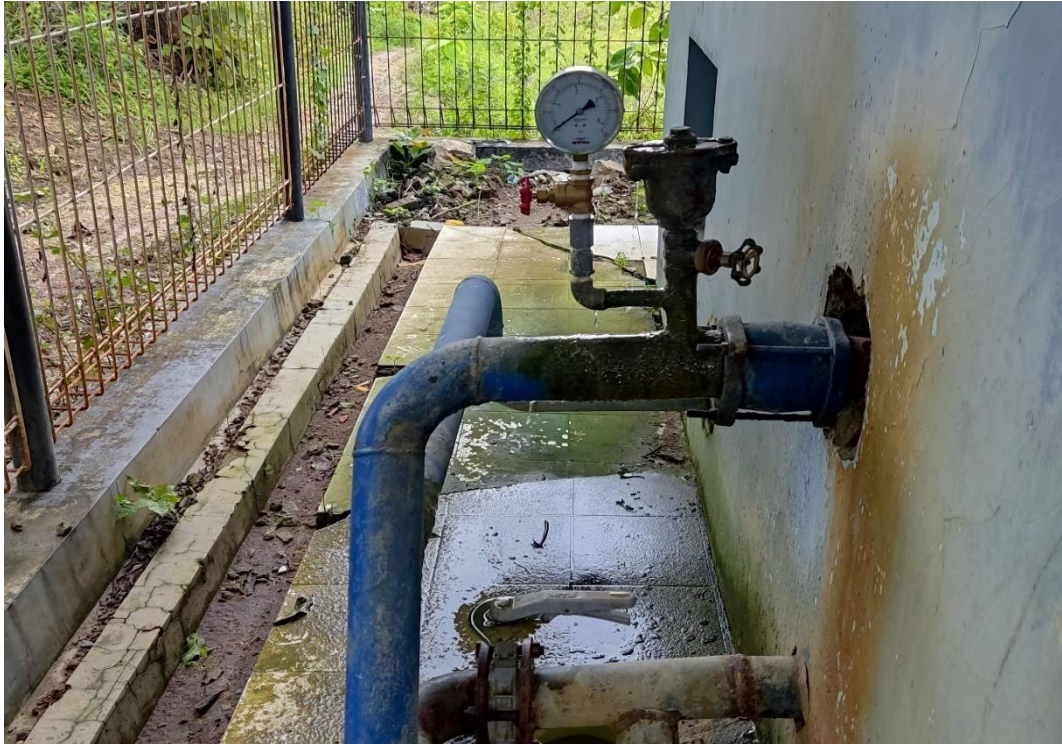
Gambar Pipa dari Pompa Submersible
